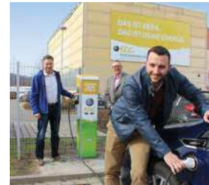
UMFORMERSTATION (HINTEN) UND STROMTANKSTELLE (VORN) NEUE STRASSE 5
